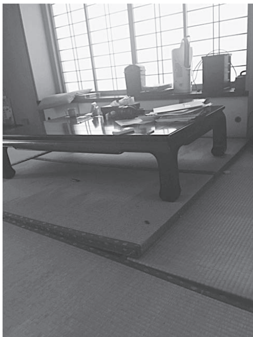
水が引いた後の1階
